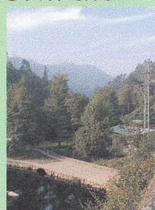
Instalación d'unha minicentral en Maciela (Covelo)
