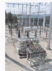
Transformadores e condutores
